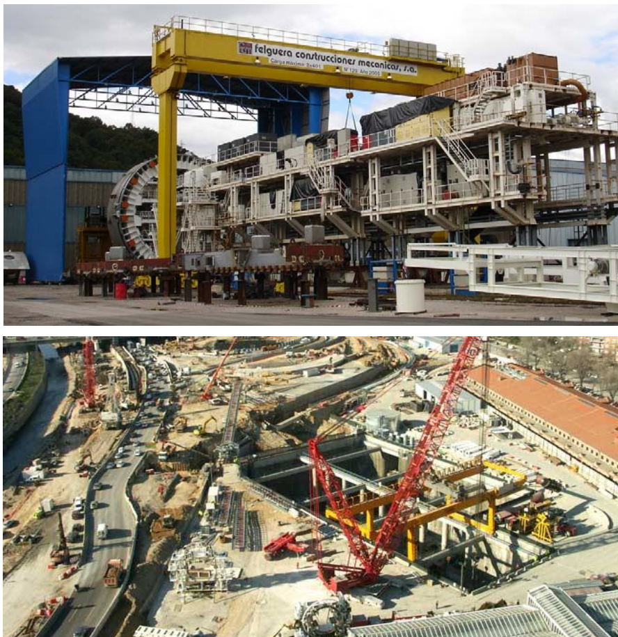
Figura 9: Montajes en factoría y en obra de los escudo de Calle 30 (Madrid).
